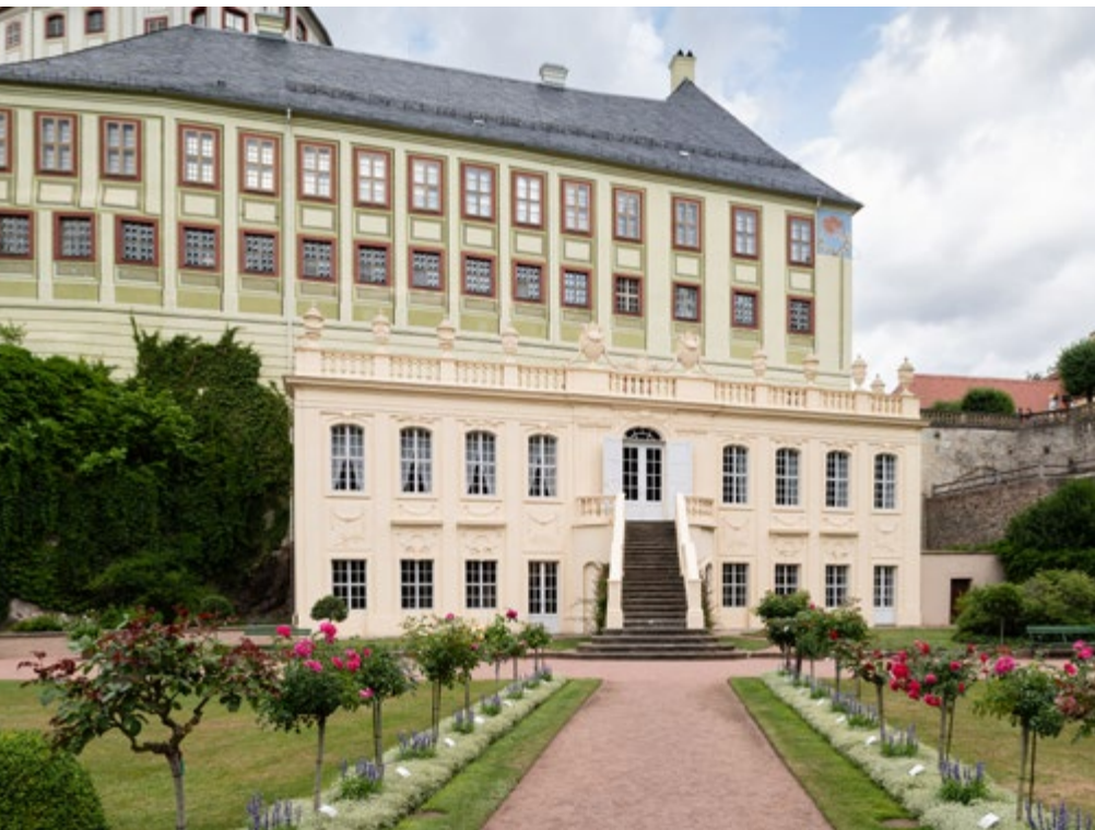
Nach zweijähriger Sanierung und Restaurierung ist der Wintergarten von Schloss Weesenstein wieder nutzbar.
