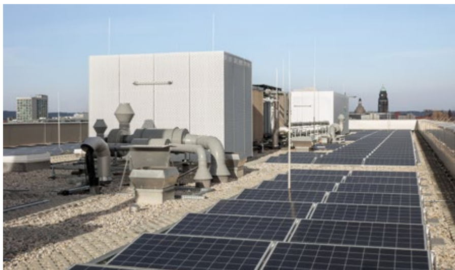
Die Dachfläche der HTW kann als „fünfte Fassade“ für Photovoltaik genutzt werden.
