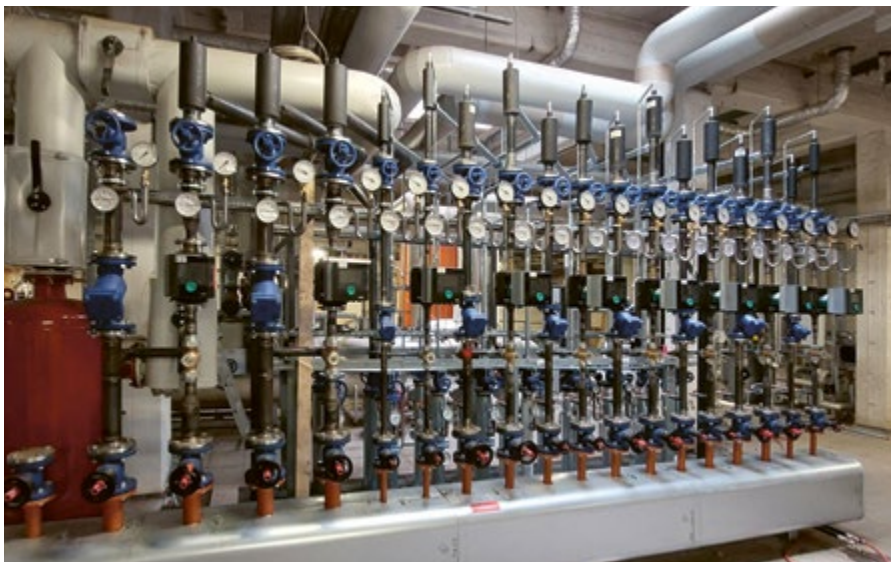
Heizkreisverteiler in der Technikzentrale
